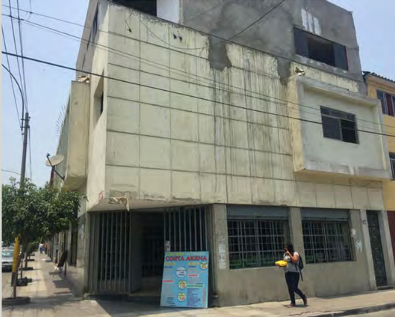
EDIFICIO EN ESQUINA CON EXCESO DE ESPACIO VACÍO EN PRIMER PISO
