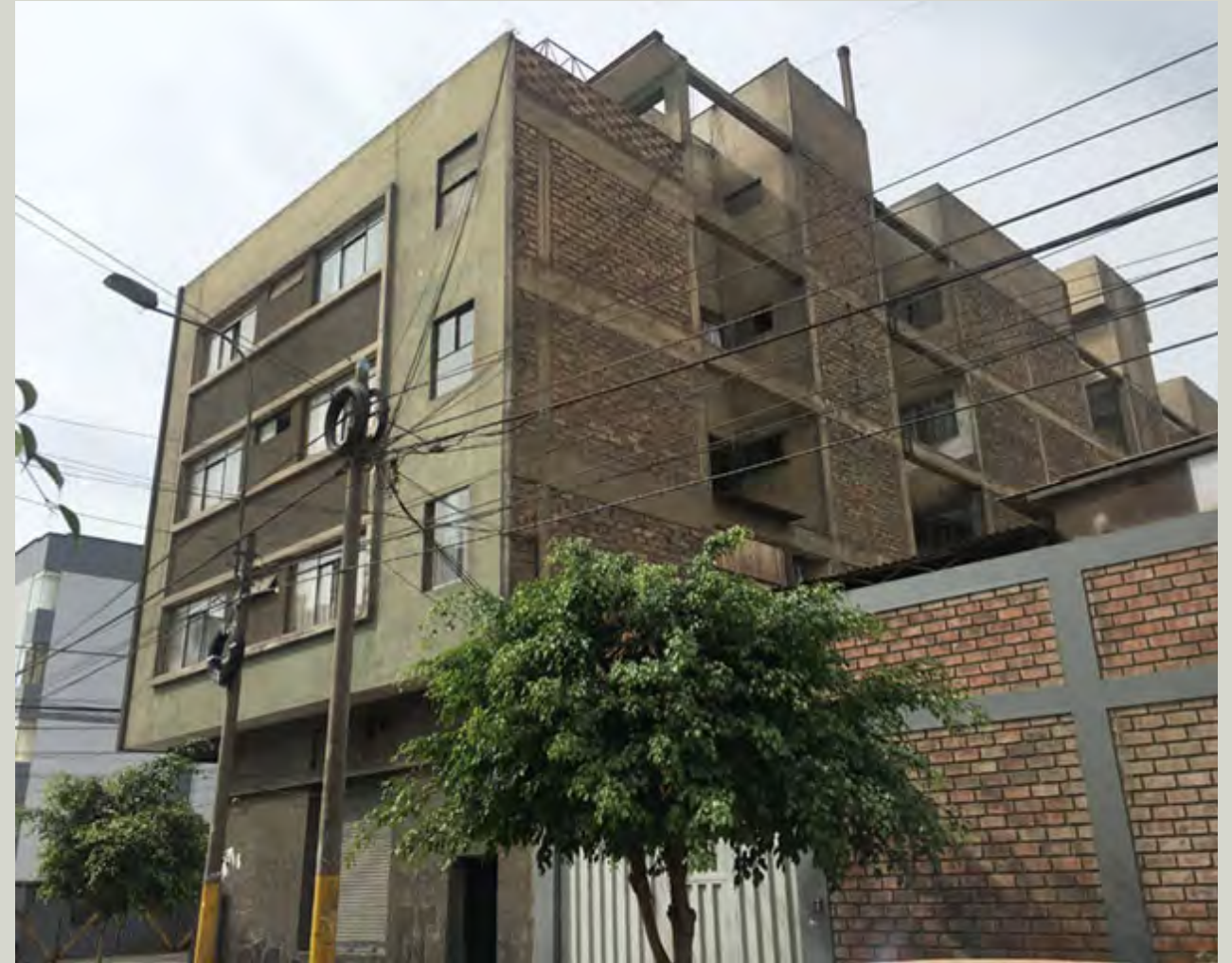
EDIFICIO CON PISO SUPERIOR SIN SOPORTE ADECUADO
